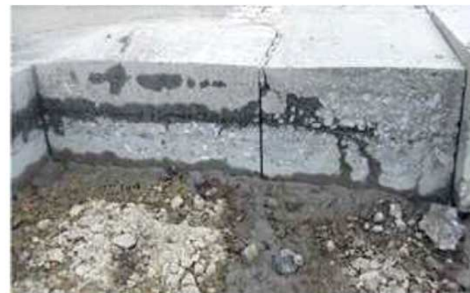
舗装内部の水の滞留による損傷
