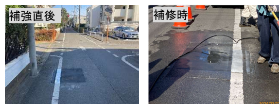
写真-9 補強直後および補修時の路面状況
