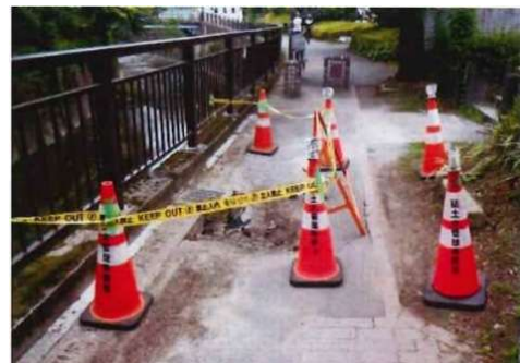
写真-11 道路陥没発生状況
