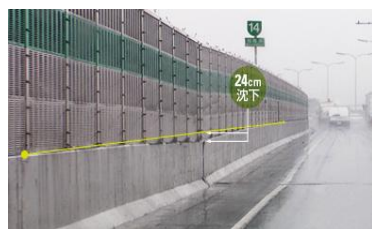
ヒンジ部沈下の状況
