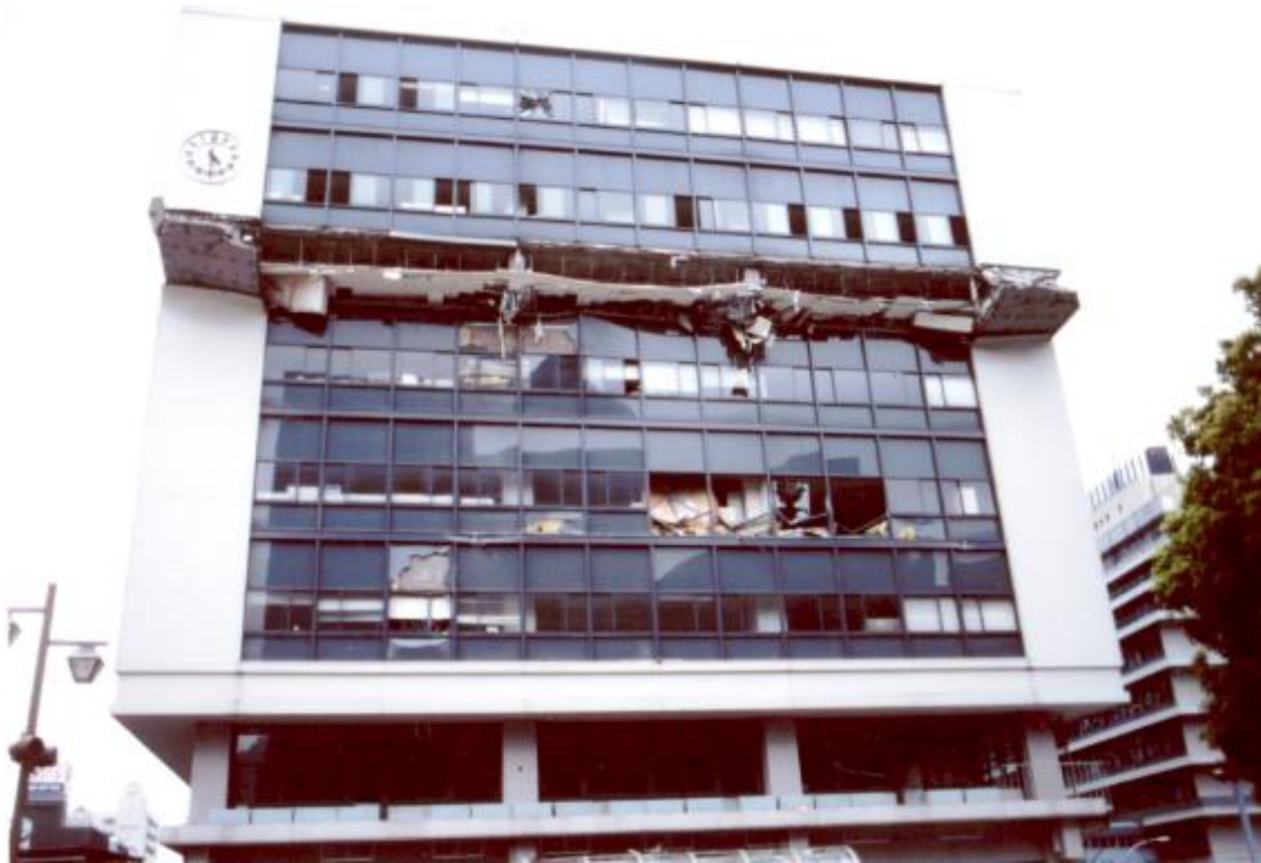
市役所2号館の被災状況（外観）
