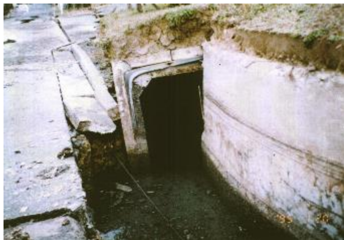
東灘処理場の被害（水路の破壊）
