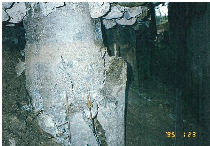
東灘処理場の被害（基礎杭の破壊）
