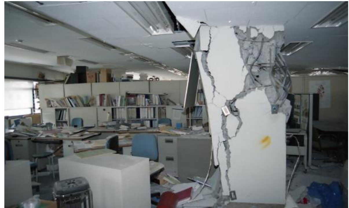
市役所2号館の被災状況（室内）
