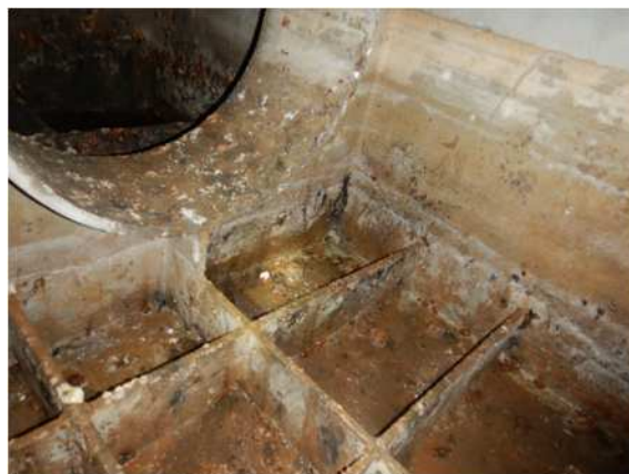
写真-1 鋼製基礎内部の腐食状況
