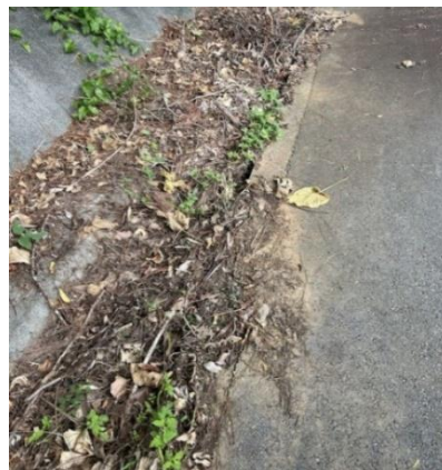
写真-4 片勾配側溝 (西表島)
