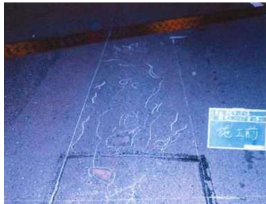
鋼床版上舗装の損傷事例
