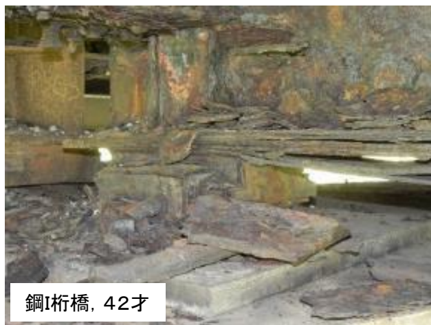
支承部の腐食
