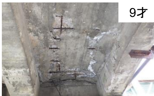
施工品質にはばらつきがある
