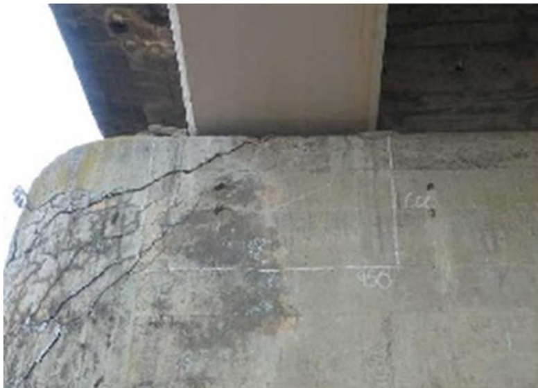
斜めひびわれ
