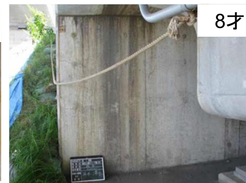
排水設計の不全は、施工してから分かることもある
