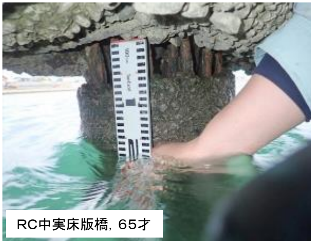
パイルベント橋脚の損傷
