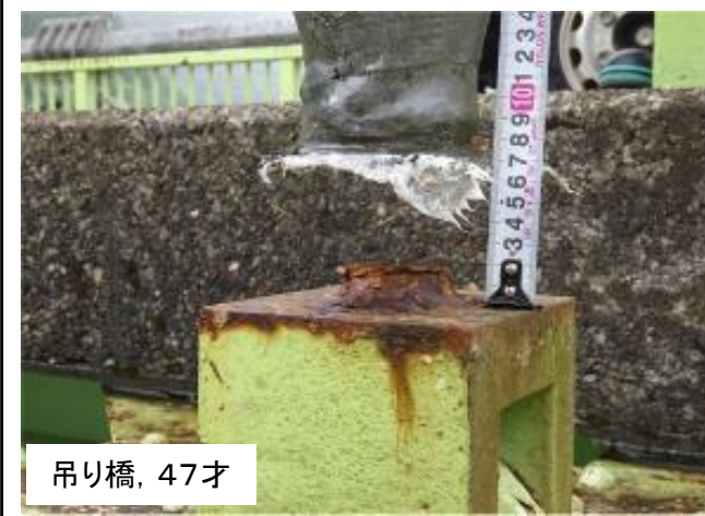
吊り橋の吊り材の破断
