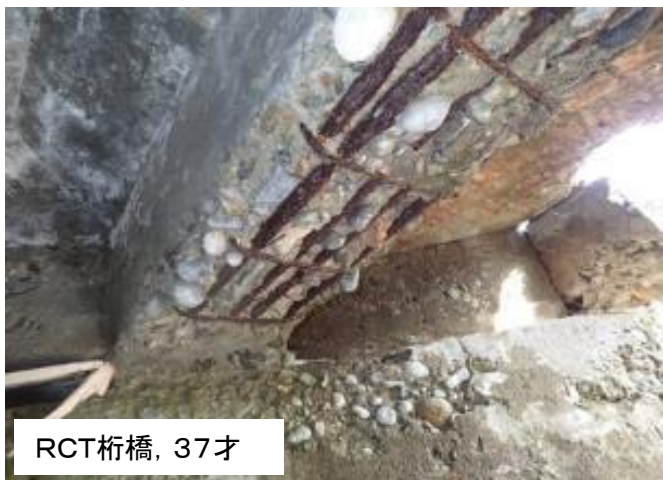
主桁のはく離・鉄筋露出
