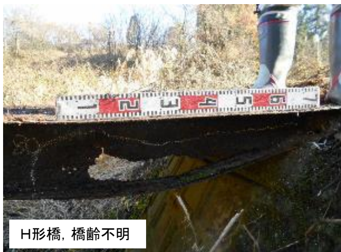
主桁の腐食断面欠損
