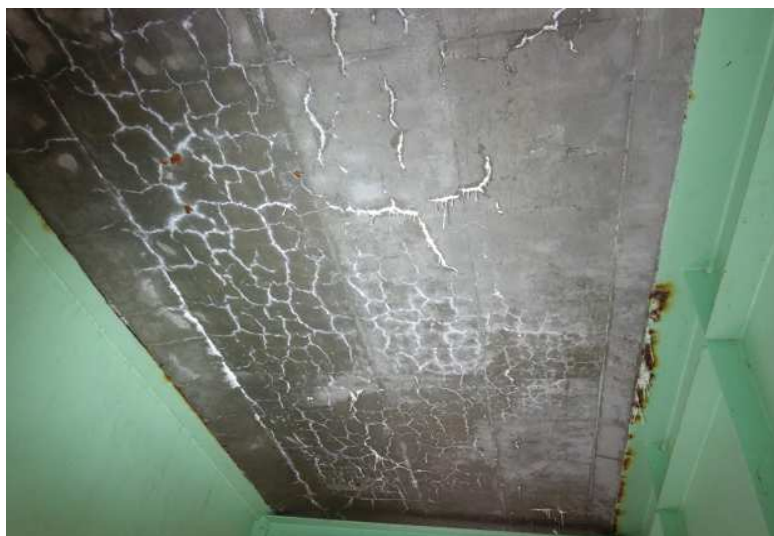
RC床版のひび割れ
