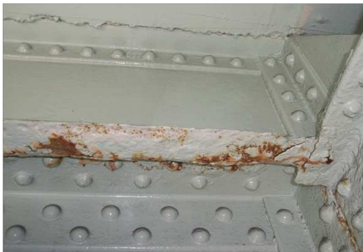
歩車道境界からの漏水による縦桁の腐食
