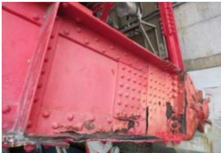
河川からの飛沫によるアーチリブ端部の腐食
