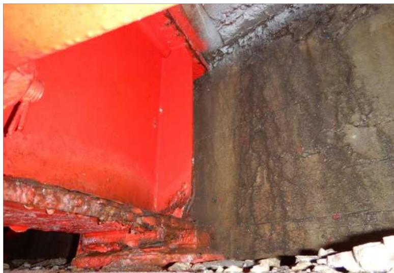
融雪剤の塩分による桁端部・支承の腐食
