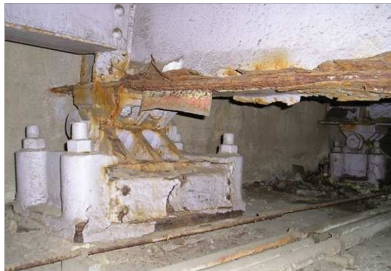
海からの飛来塩分による桁端部・支承の腐食
