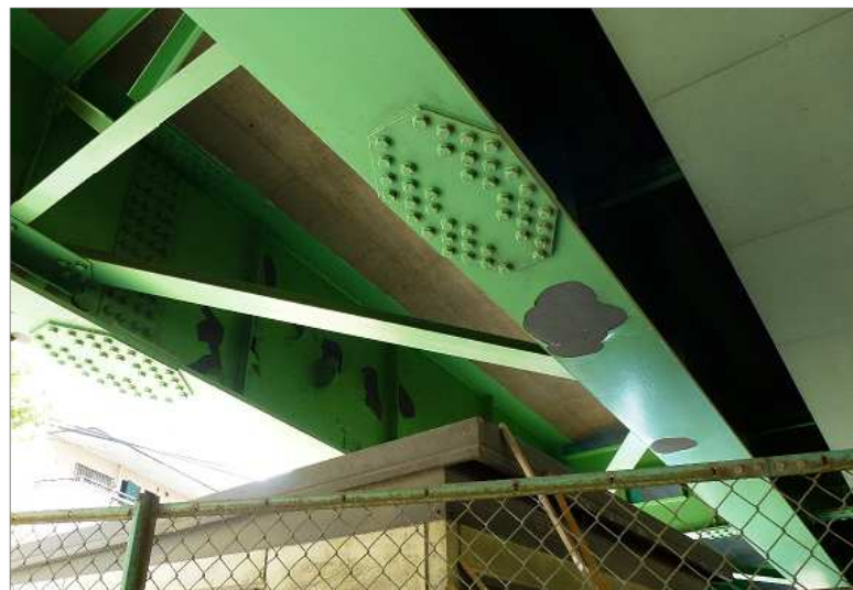
塗膜の層間剥離
