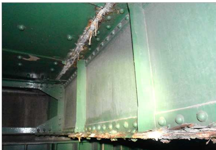
接着鋼板・桁の腐食
