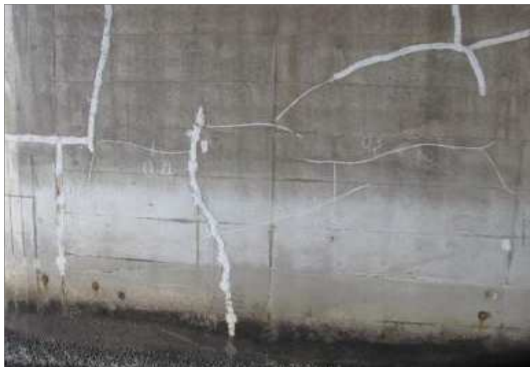
橋台縦壁部のひび割れ
