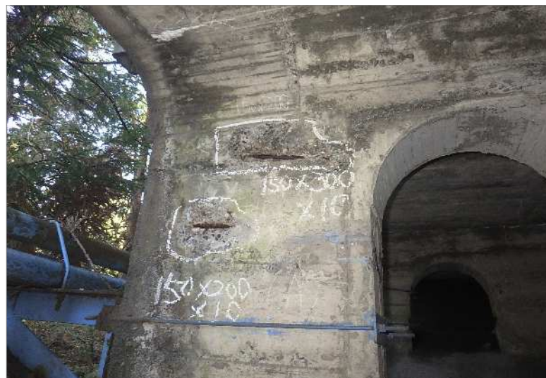
RCアーチ鉛直材の浮き・剥離
