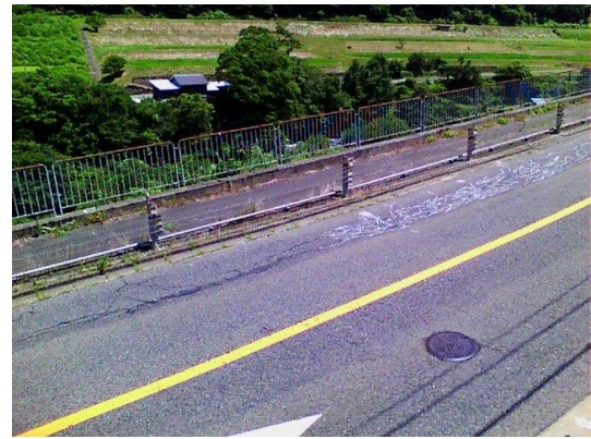
図-8 国道9号線の轍（写真の白い部分）
