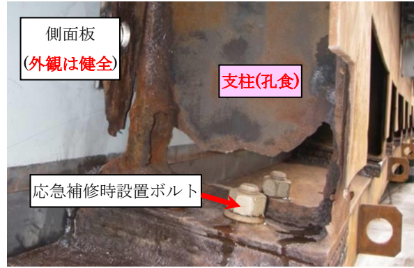
写真-9 高欄内外での腐食進展の違い
