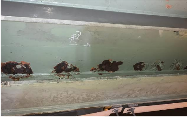
写真-6 縦シーム用ボルト 外部排水による腐食
