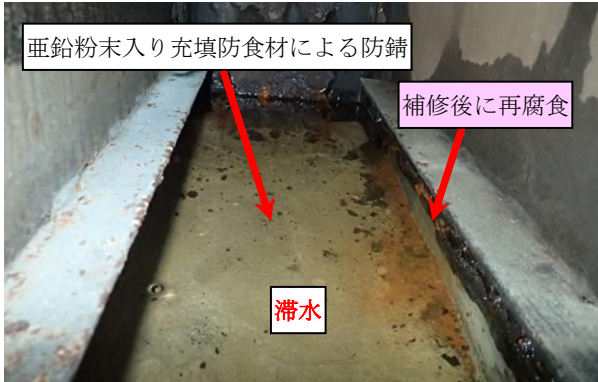
写真-11 補修後の損傷の再発
