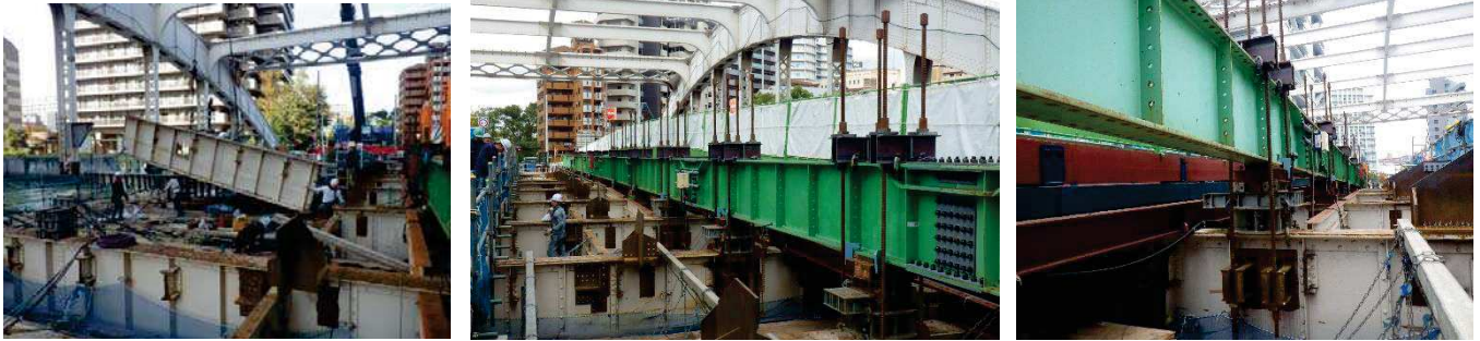
写真-2 既設横桁撤去状況・工事桁配置状況・横桁吊り設備
