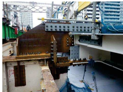
写真-4 既設横桁連結治具
