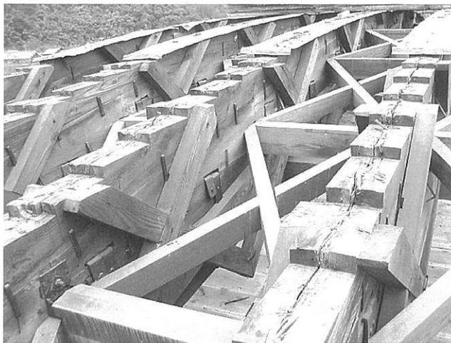
木材特有の釘による割れ
