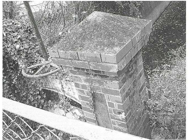
写真三 レンガを使った水門の塔（鴻巣市内）
