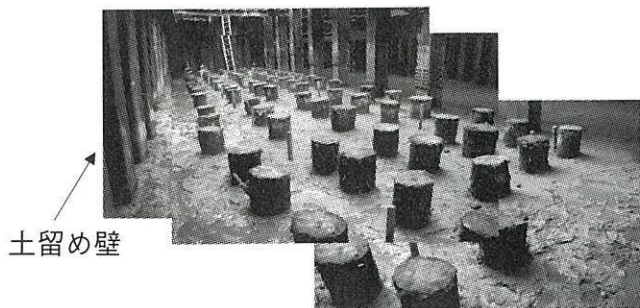
写真-1 杭頭の露出状況
