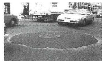
写真-3 一時交通開放時における マンホール蓋周辺の危険なすり付け
