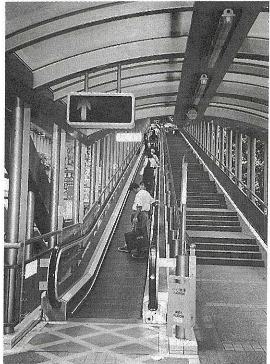
写真-17 ヒルサイドエスカレーター
