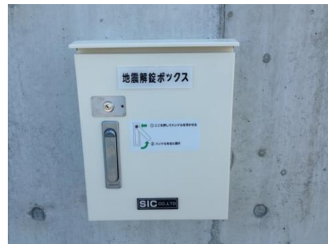
(換気所外階段と地震解除ボックス(鍵入れ))
